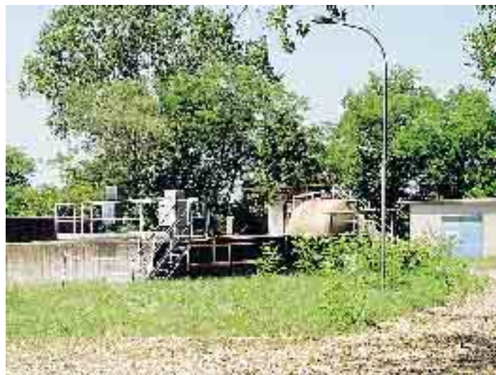
CASTELSANGIOVANNI - Il depuratore comunale di Cà dei Tre Di (foto Bersani)
