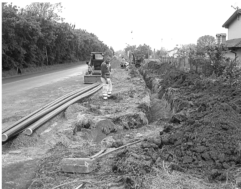
Nelle foto, un momento dell'incontro ieri mattina nel Municipio di Fiorenzuola con Eugenio Bertolini , Giovanni Compiani e Vittorio Silva e i lavori in corso a San Protaso per la posa di una conduttura che collegherà i due nuovi pozzi con il serbatoio pensile della frazione
