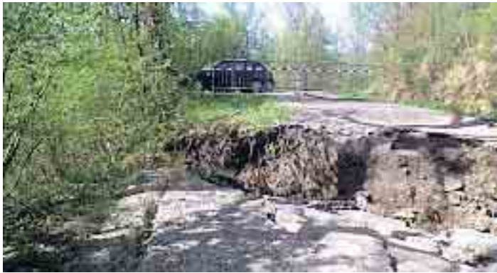
FERRIERE - La strada devastata dalla frana in località Cerri
